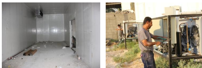
Les derniers préparatifs avant la mise en route de la chambre froide de Marj al Ghazal
