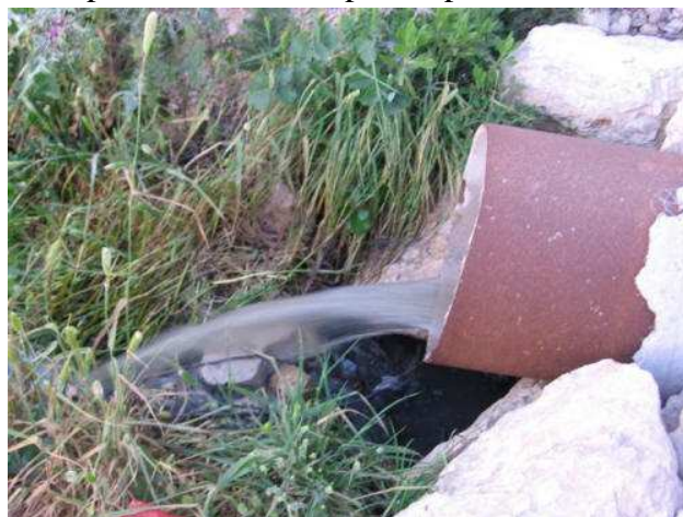
Un des exutoires de trop-plein la station d'épuration de Betar Illit, se déversant directement dans la vallée (Youth Development Association, 2010)
